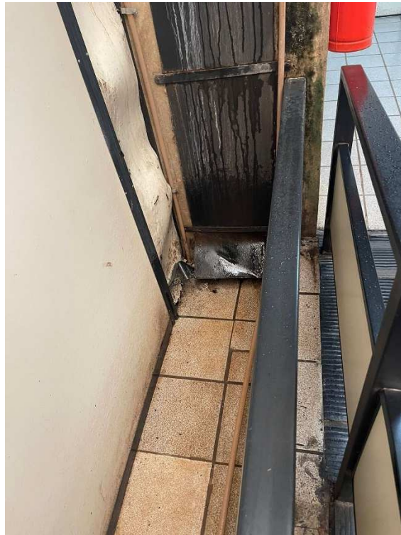
Foto 09: Condutor de águas pluviais.
